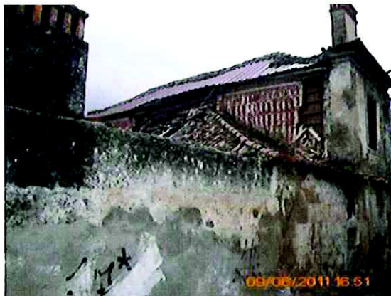
Figura 3 – Edifício em ruína com duas frentes para a Rua dos Pescadores e Espírito Santo
