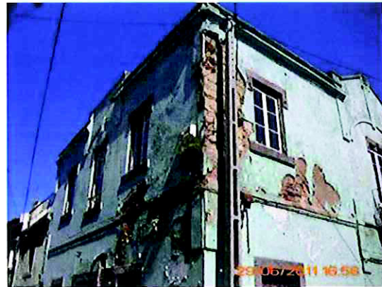
Figura 2 – Edifício devoluto na Rua Espírito Santo e Travessa da Oliveira
