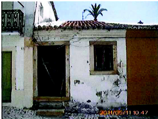
Figura 1 – Edifício devoluto no Largo de Palmela
