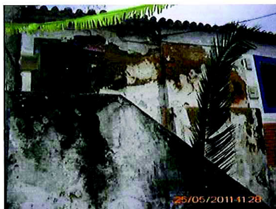
Figura 5 – Edifício em mau estado de conservação na Rua dos Pescadores
