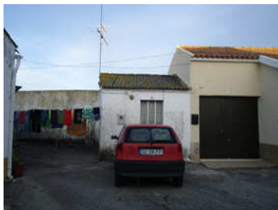
Figura 6 – Edifício em mau estado de conservação na Travessa de César
