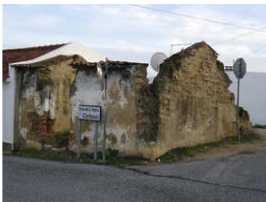
Figura 3 – Edifício em ruína na Rua de César
