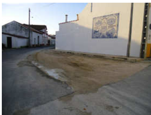
Figura 8 – Pavimento em mau estado
