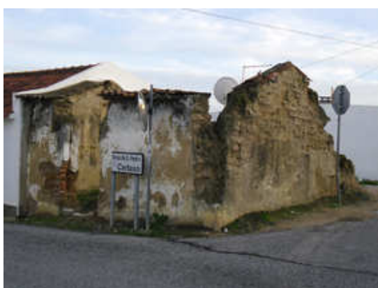
Figura 3 – Edifício em ruína na Rua de César
