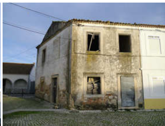
Figura 2 – Edifício devoluto na Rua de Sertório
