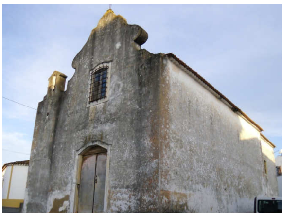
Figura 1 – Igreja em mau estado de conservação no Largo de Santo António
